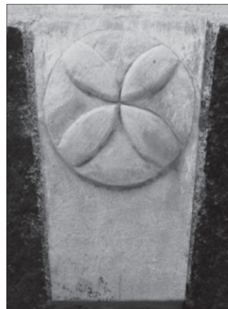
Il concio di chiave di volta del portale d'ingresso alla cappella della Regina.
